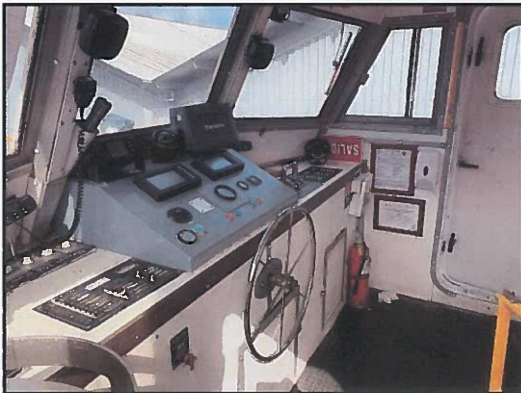
Foto No.6 Interior de cabina de control
